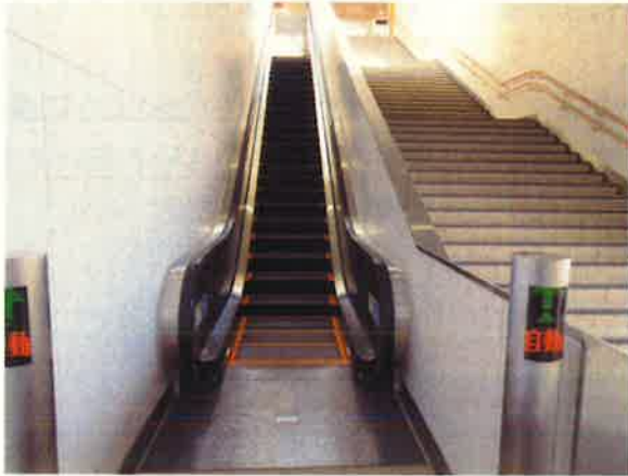
(自由通路の昇りエスカレーター)
