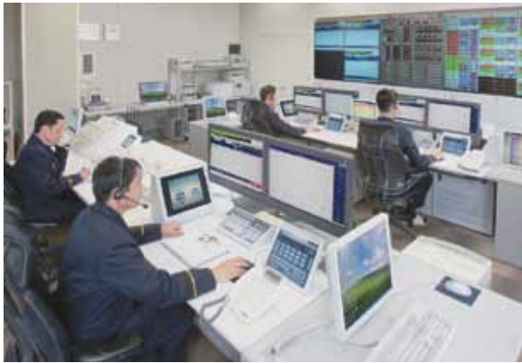
機能が更新された高機能消防指令センター
